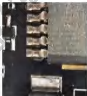
位于电源输入端， MOS管型号
